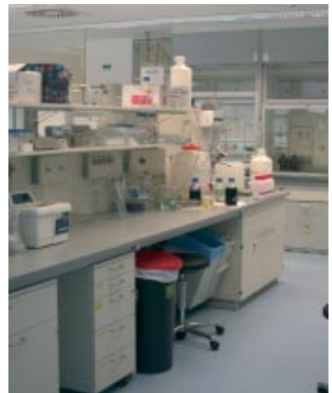
Die ehemaligen Räume des ZIK auf dem Oberen Eselsberg werden zu Forschungslaboren umgebaut.
